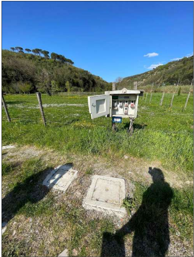
foto Q - dettaglio quadro e pozzetti esistenti
