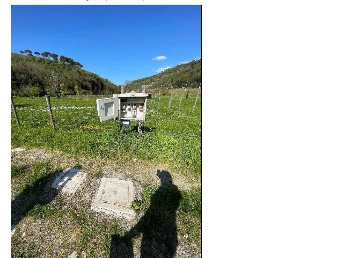
foto Q - dettaglio quadro e pozzetti esistenti
