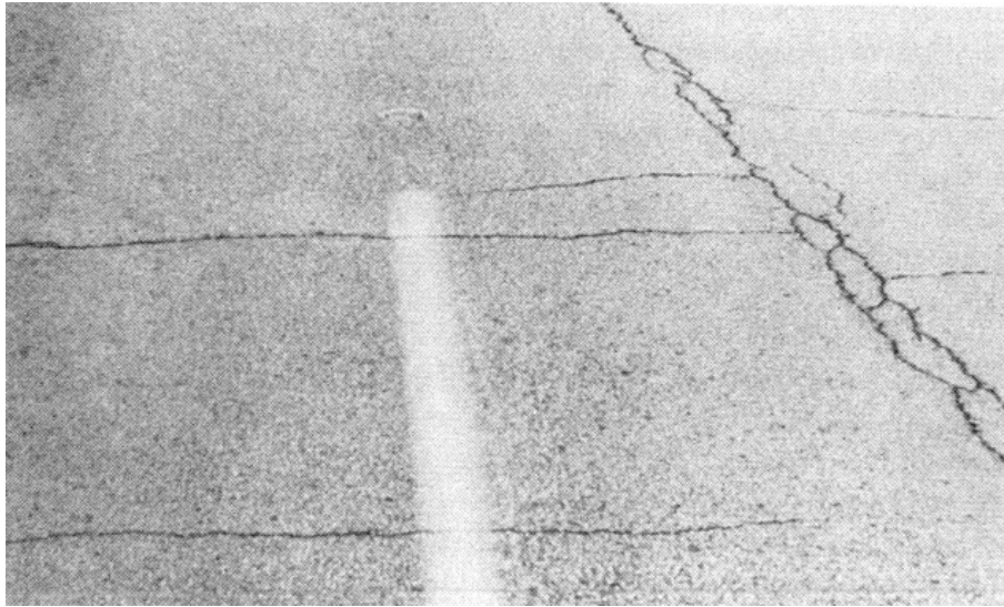
Figura 5: Fessurazioni da propagazione
