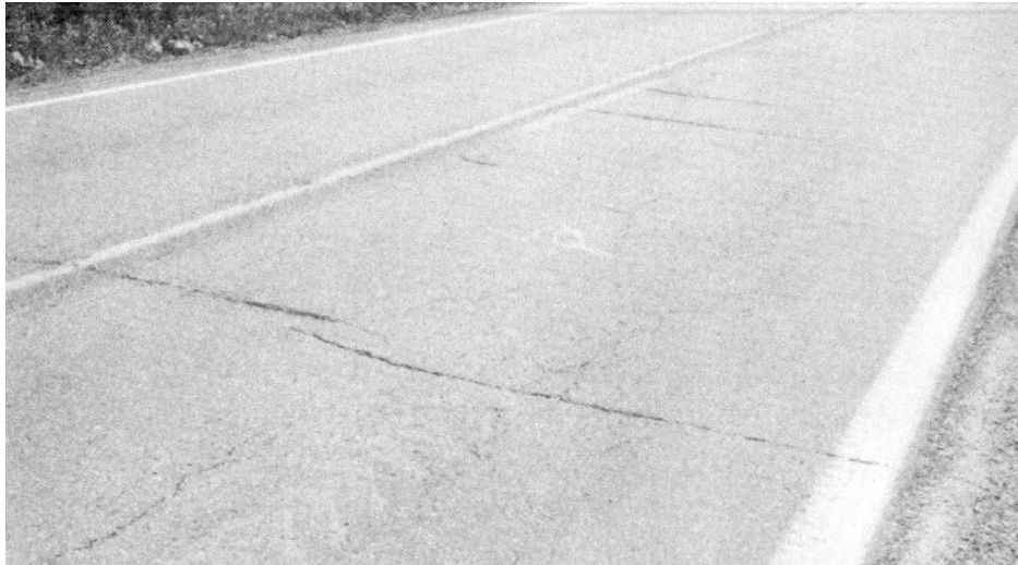
Figura 2: Fessurazioni da stress termico alle basse temperature
